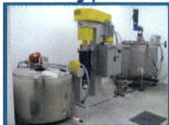
Broyage des boues/Mud grinding
