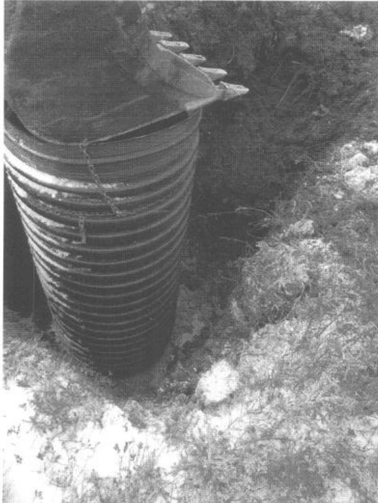
Figure 11 : Tuyau (utilisé comme caisson) en position verticale, déposé sur l'argile avant le remblaiement tout autour
