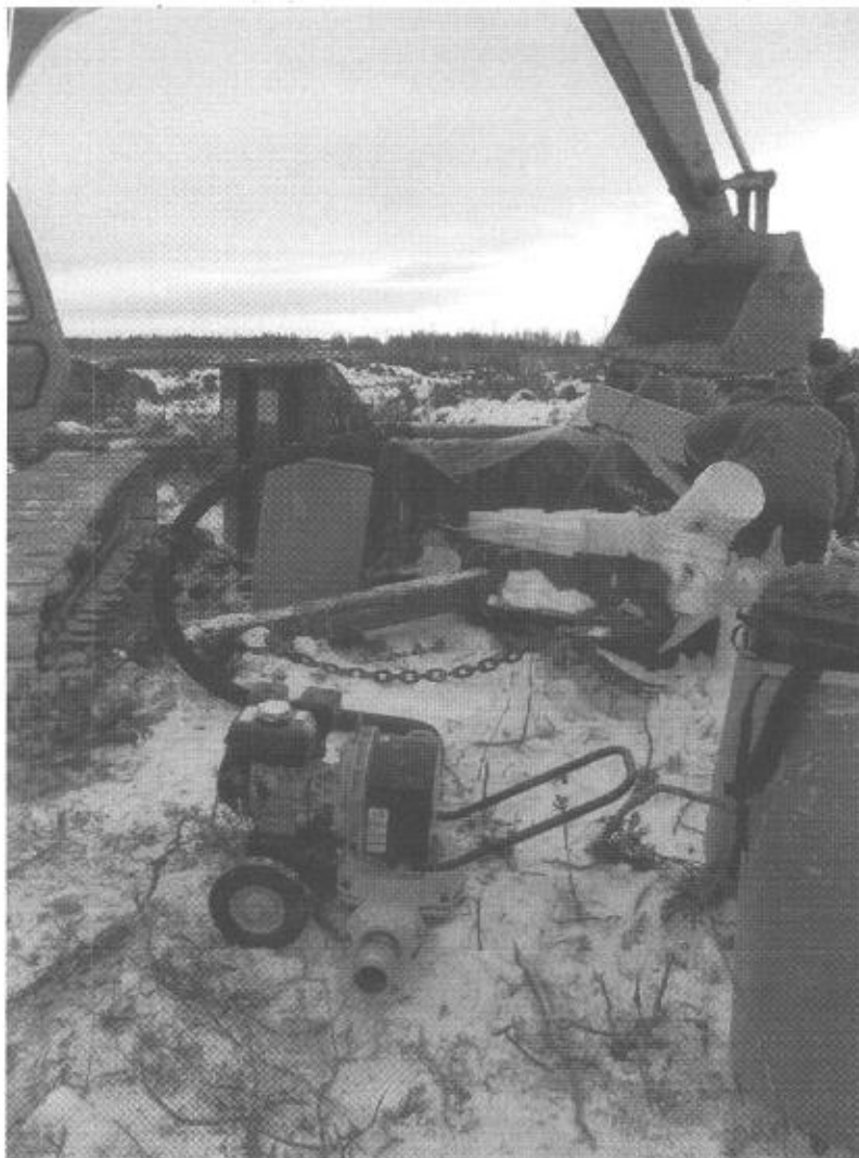
Figure 13 : Pompe utilisée pour le test avec en arrière plan le bac contenant l'argile liquéfié par l'excavatrice.
