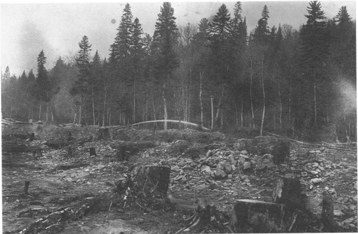
FIGURE 1E - Dominion Gold Fields Ltd. Ajutage (voir Levat, 1905, page 360) en opération (un ajutage est une lance à eau conique reliée au tuyau d'alimentation par un joint mobile qui permet de diriger le jet). L'eau est dirigée dans le sluice (ce dernier est construit sur le roc; les strates servent de riffles) qui aboutit à l'élévateur.
