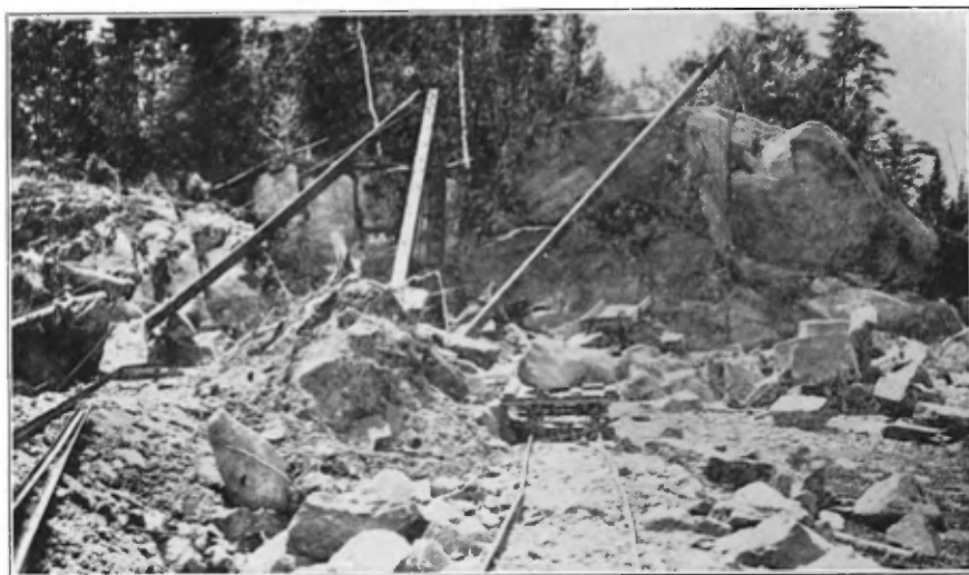
B.—Carrière de Granit National Enrg., Saint-Gédéon, dans de l'anorthosite noire. On voit le pendage du sens (rift) à gauche, en arrière de la flèche du derrick.
