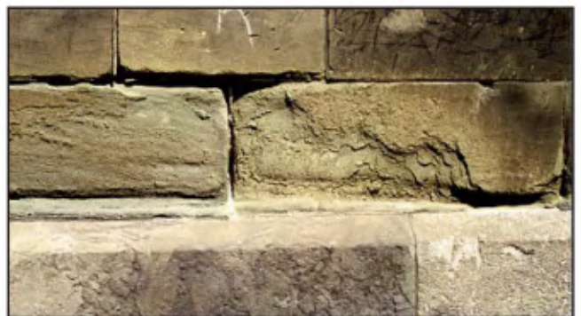
Disintegration of Bouctouche sandstone, 1, rue des Grisons.
