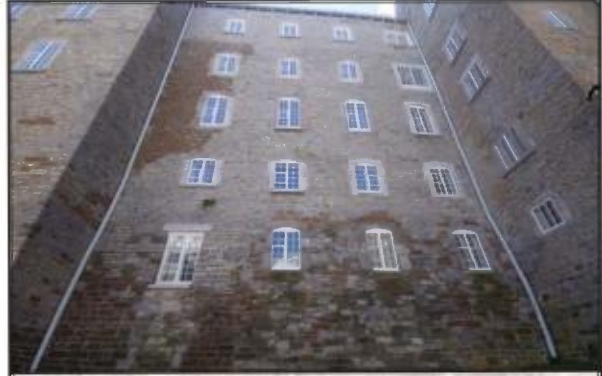
Cour du Séminaire : murs reconstruits avec diverses pierres, incluant du calcaire de Château-Richer, des grès de l'Ange-Gardien et de Sillery et de la pierre noire du Cap.
