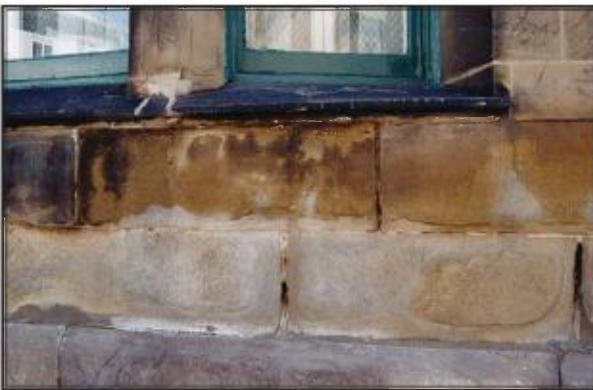
Grès de Bouctouche altéré : écaillement et désagrégation sableuse, oxydation rouille et absorption de suie noire.
