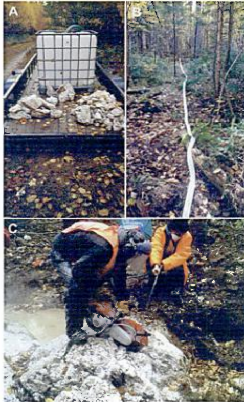
Figure 15. Photographies de terrain montrant un réservoir d'eau de 1000 litres (A), un boyau d'arrosage de haute capacité (B) et l'équipe technique lors d'un rainurage (C).
